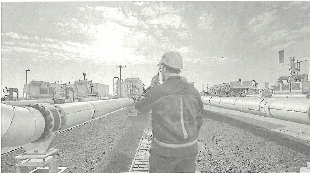
Gasspeicher von VNG in Bad Lauchstädt
